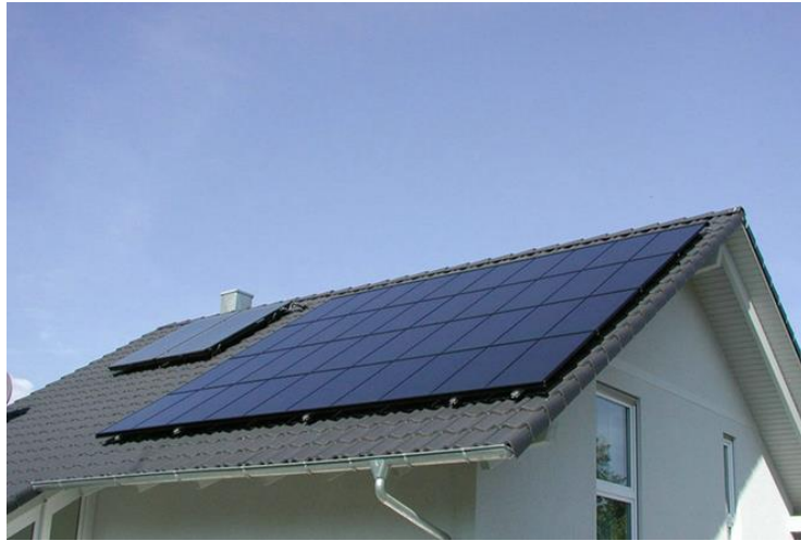
Figur 9: Typisk BAPV solcelleanlegg montert på saltak.
